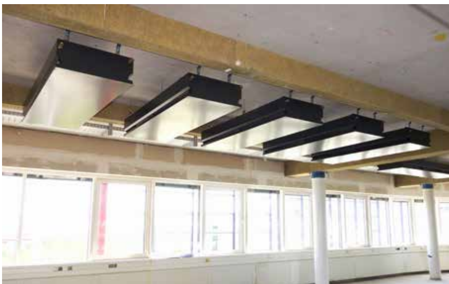
Büroflächen mit Kühlkonvektoren des Typs COOLLINE vor Endmontage der Abhängecke
