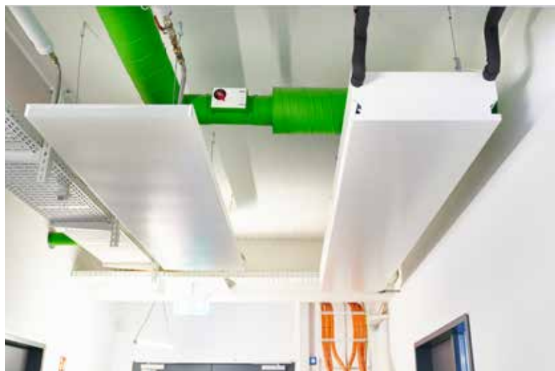
Kühlkonvektor (links) in Kombination mit einem Heiz- und Kühlsegel (rechts)
