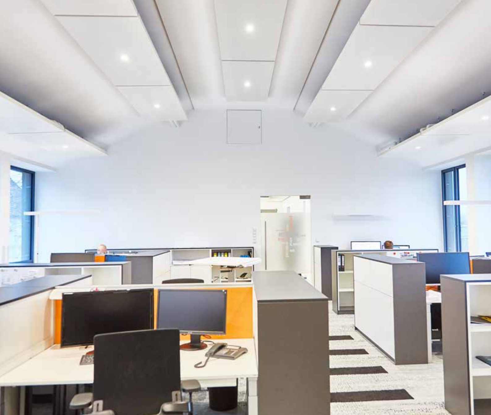
Umbau Schule in Büro: Kühlkonvektoren "unsichtbar" oberhalb der Abhangdecke
